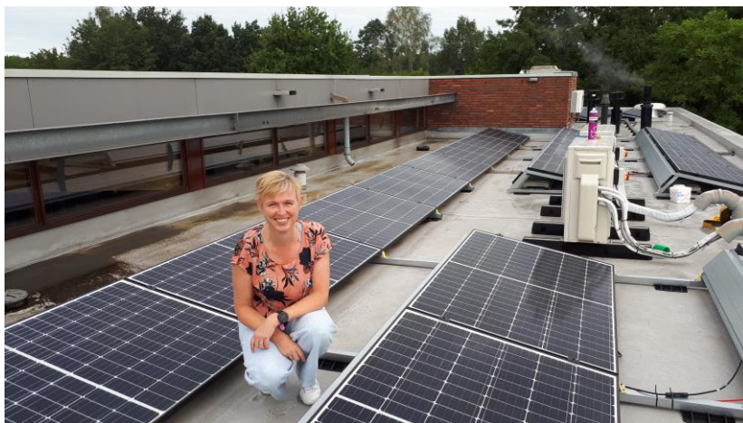
Het volledige platte dak van het hospice is benut om de 128 zonnepanelen te kunnen plaatsen.
