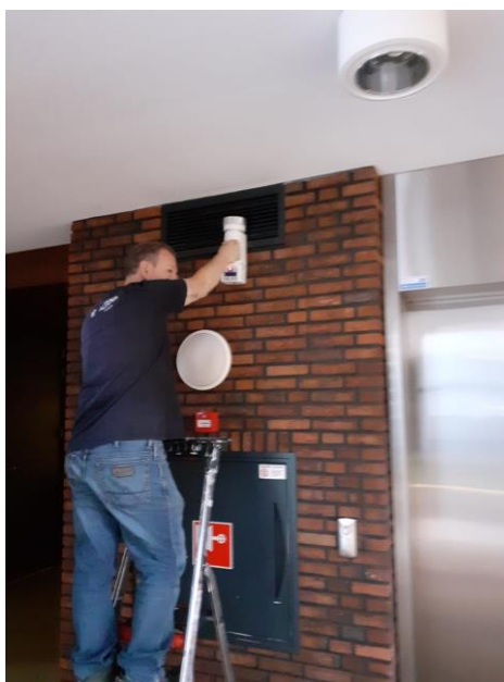
Controle van het ventilatiesysteem.
